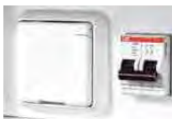
Розетки, автомат УЗО
