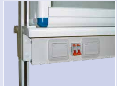
2 розетки и 2 АЗС в электрокоробе островного стола
