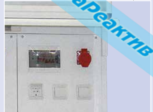
Распределительный щит с 5 АЗС, силовая розетка и 3 розетки на съемной панели сервисной стойки
