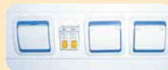
Розетки, АЗС, выключатель
