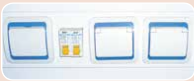
Электроблок вытяжного шкафа, состоящий из 2-х брызгозащитных розеток, 2-х автоматов защиты сети и выключателя светильника
