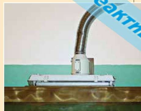
Вентилятор канальный установленный на шкаф и алюминиевый гибкий воздуховод
